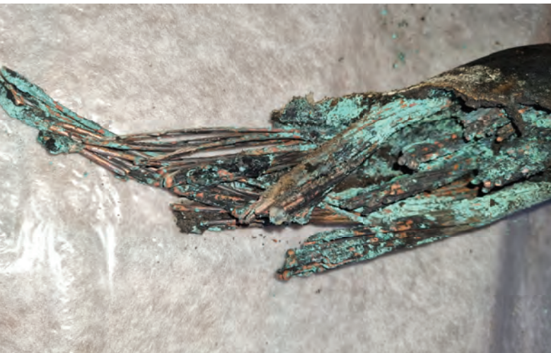
Impressionen nach der Explosion der Elektroinstallationen in der Kirche Wintersingen.
